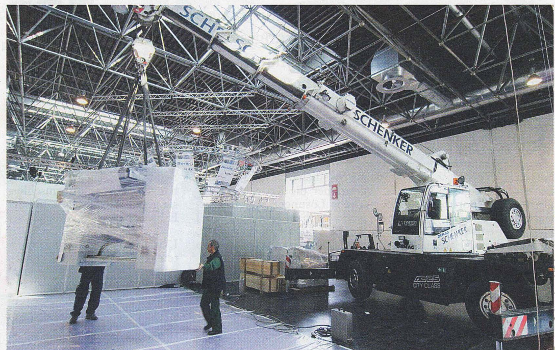
DB Schenker rechnet mit mehreren tausend Tonnen Material, das nach Hannover bewegt werden muss. 40 Gabelstapler und bei Bedarf auch Kräne wie dieser stehen vor Ort zur Verfügung.
