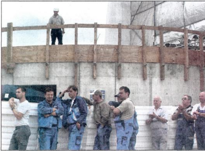
Pause für die Bauarbeiter: Polier Jens Schmidtchen (oben) sprach gestern den Richtspruch für das neue Firmengebäude der DAKO. Foto: tlz/Jördis Bachmann
